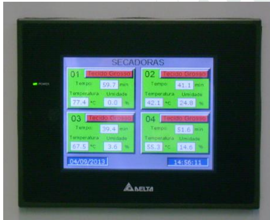
Painel de operação centralizado
